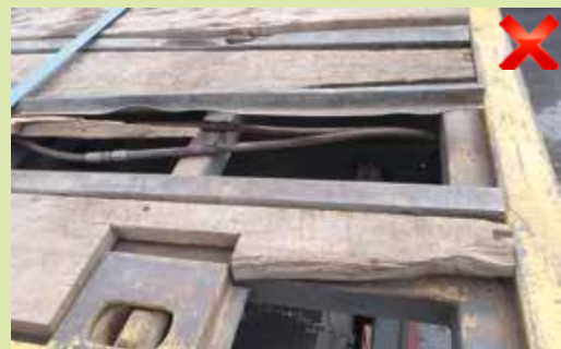
Plancher de chargement en mauvais
